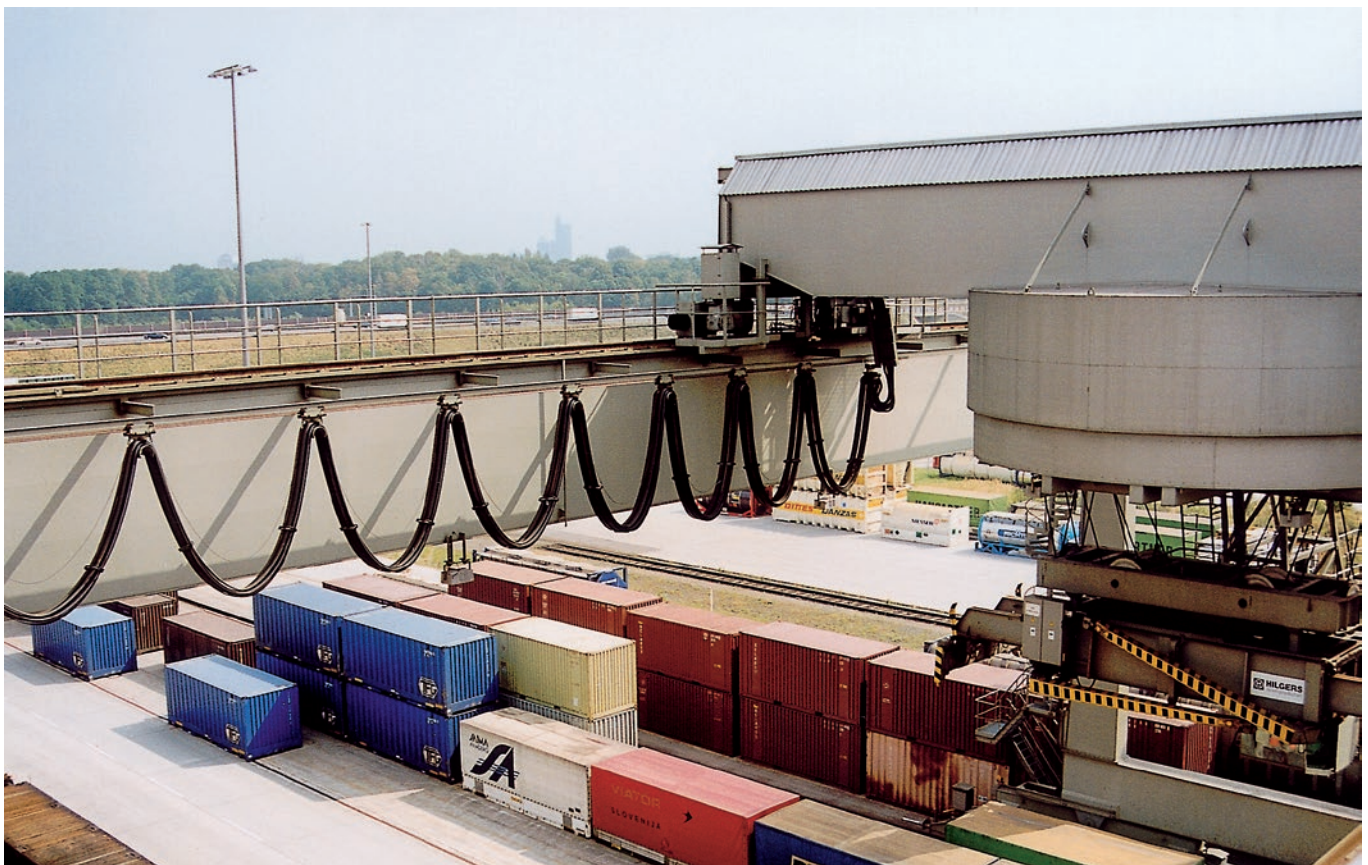
Leitungswagenanlage an einem Containerkran
