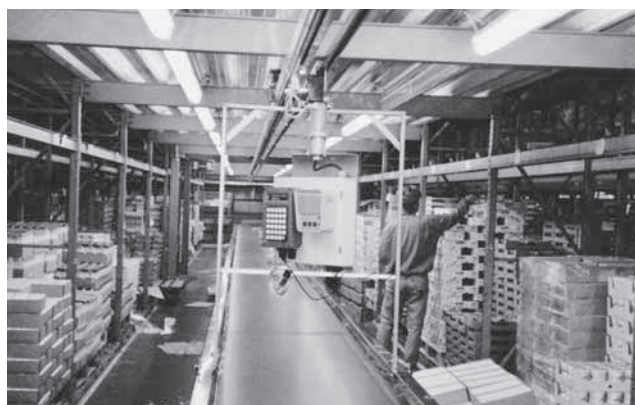
KTW-System in einem Pick-Lager
