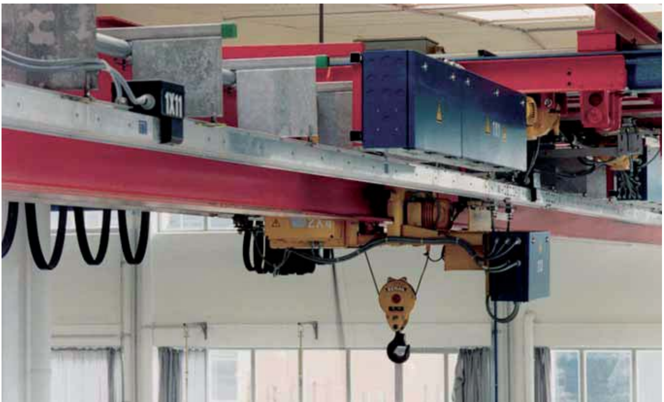
Sicherheits-Schleifleitung LSVG an einer Kranbrücke.
