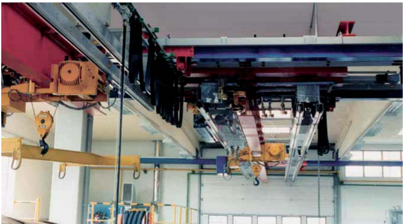
Sicherheits-Schleifleitung an einer Kranbrücke.
